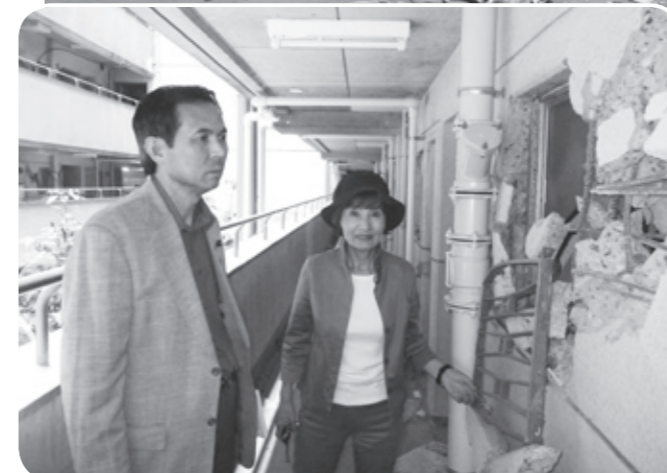
6月10日仙台市内の損壊住宅を視察する村岡県議(左)、柳下県議(右)
